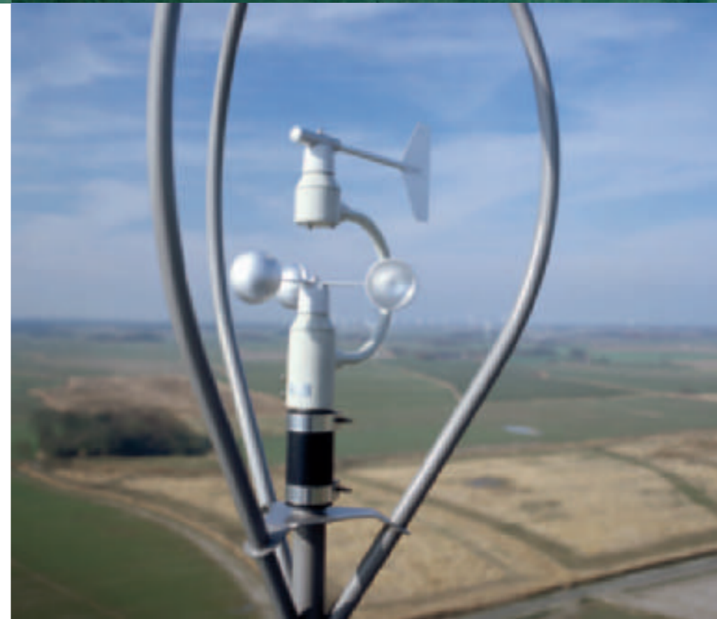
Anémomètre et girouette sur la nacelle de la ENERCON E-70
